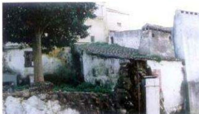
Habitação degradada no Centro Histórico da cidade.
