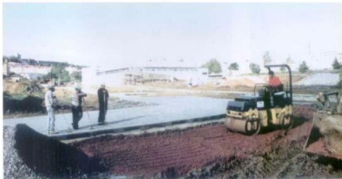
Estão a ser construídas as infraestruturas de acesso ao novo Pavilhão Gimnodesportivo
