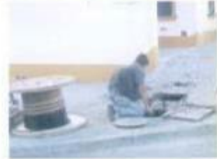
A instalação de infraestruturas para a TV Cabo está a decorrer na cidade de Matemios-Novo, após um acordo entre a autarquia e a empresa Cabo Visão
